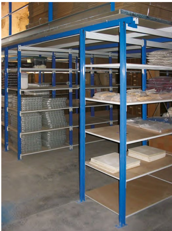
Installation de rayonnages ACTI-PLUS avec tablettes recouvertes de bois aggloméré 8 mm pour le stockage de produits non conditionnés comme des carrelages, des sacs de matières premières et des plaques (Adetech)
